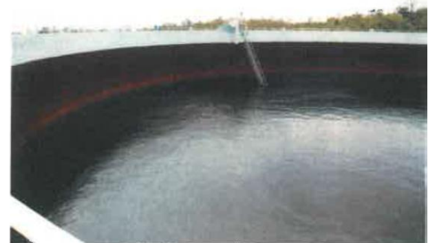
浮き屋根の沈下の状況 8
