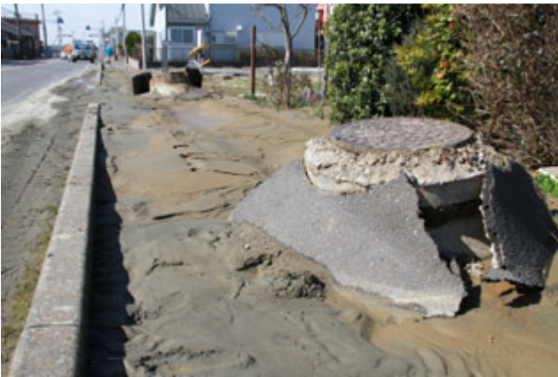
写真2.4-2 マンホールの浮き上がり(千葉県香取市) 1)
