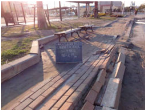
写真2.4-3 液状化による歩道境界ブロックの破損(千葉県浦安市) 2)
