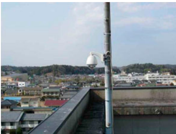
写真4.8-18 火災監視カメラ (双葉地方広域市町村圏組合消防本部提供) 2)
