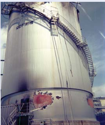
平成 15 年 三重県のゴミ固化燃料 (RDF) 発電所で発生した RDF 貯蓄槽の爆発事故 2003 RDF storage tank explosion at an RDF power plant in Mie Prefecture
