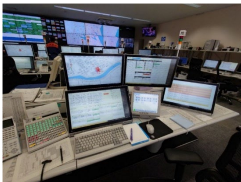
写真1 指令センターの様子：指令台
