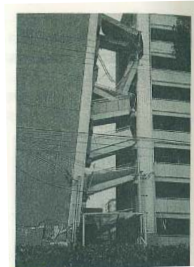
写真4 渡り廊下落下
