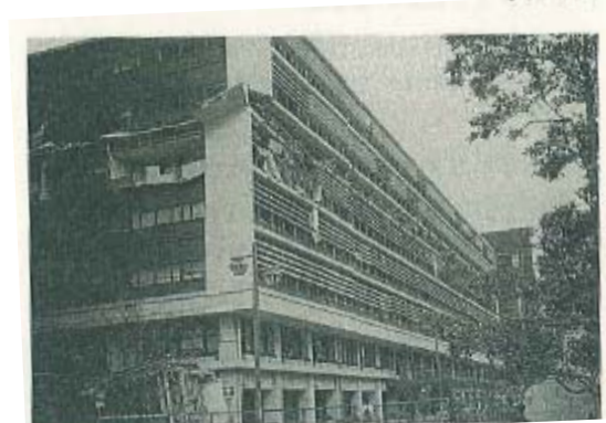
写真2 8層建物：6層崩壊
