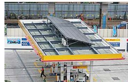
ガソリンスタンドに設置された太陽光発電設備 (写真:(一社)太陽光発電協会 提供)
