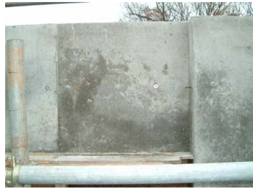
図 2.2.3.6 コンクリート表面への エコボードの部分的な付着状況(梁)
