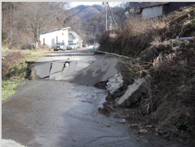
断層による地盤のずれ(白馬村塩島)
