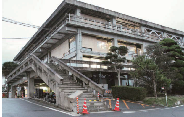
窓ガラスが割れ、ベニヤ板で応急措置をした市役所 倉吉市提供
