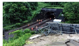
<太陽光パネルの崩落>
