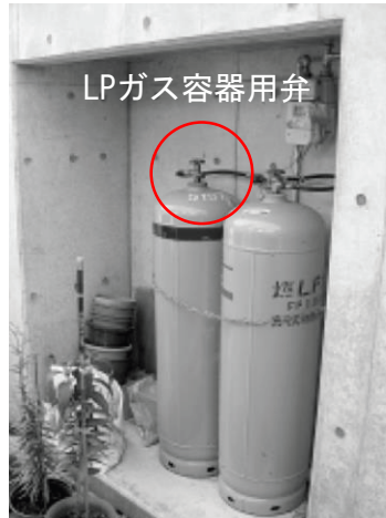
LPガス容器の設置の例
