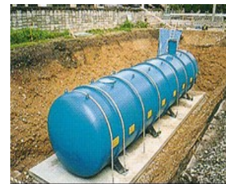
【耐震性貯水槽】
