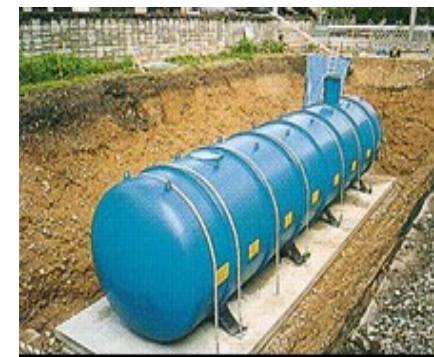
【耐震性貯水槽】
