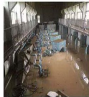
浸水被害を受けたポンプ施設
