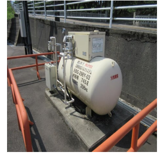
災害対応型LPガスバルク供給システム
