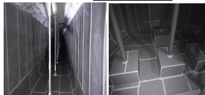
【防火水槽内部写真】支柱等を設置し、水槽強度の強化（長寿命化）
