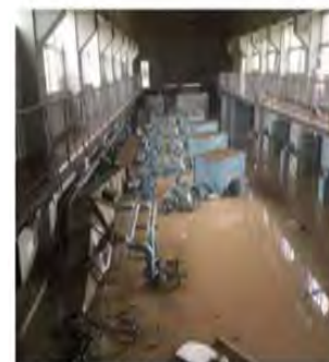
浸水被害を受けたポンプ施設
