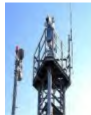
津波監視カメラ
