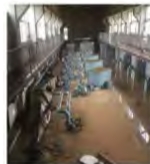
浸水被害を受けたポンプ施設
