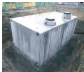
耐震性貯水槽
