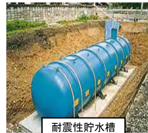
耐震性貯水槽
