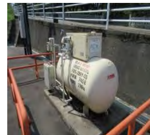
災害対応型LPガスバルク供給システム
