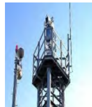
津波監視カメラ
