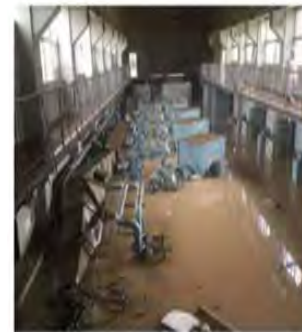
浸水被害を受けたポンプ施設
