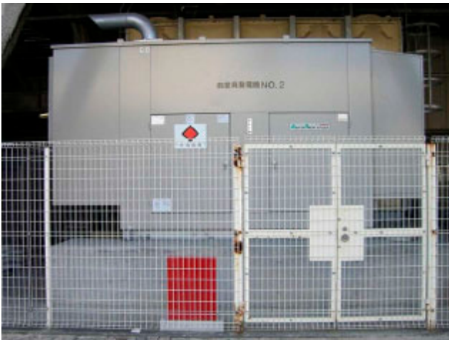
写真3.3-83 1階半屋外に設置された自家用発電機 1)
