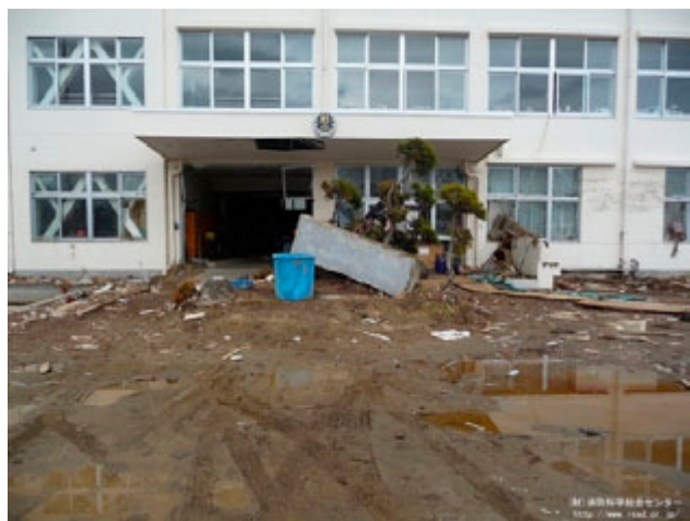
写真3.3-65 津波の被害を受けた小学校 1)
