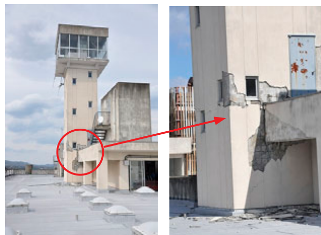
写真3.3-75 被災した山元町庁舎 4)
