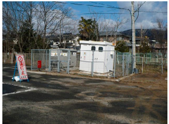
写真3.3-84 屋外設置された伊達郡国見町役場の自家用発電機 4)
