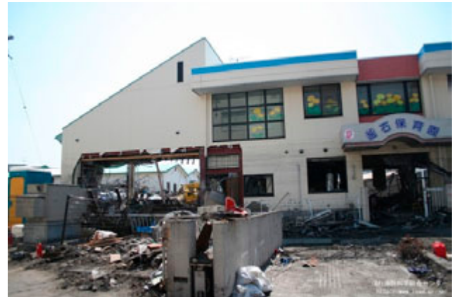
写真3.3-85 津波の被害を受けた保育園 2)
