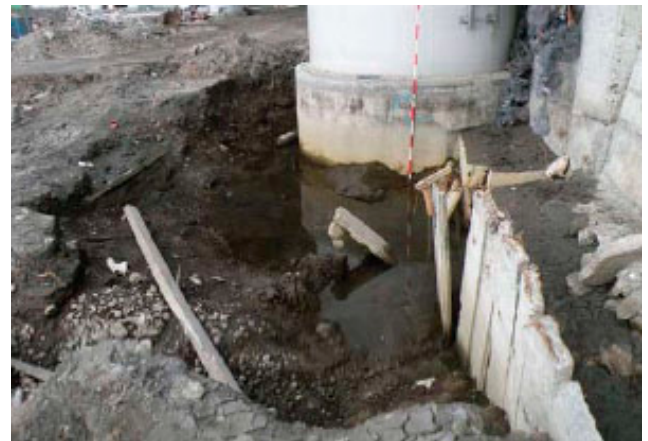
写真3.3-63 基礎の洗掘被害の様子 3)
