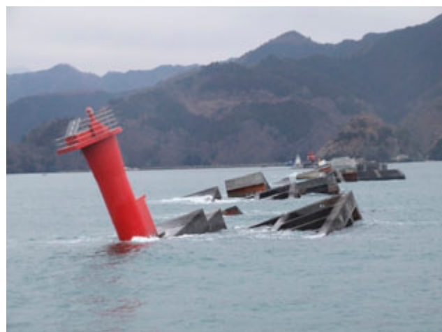
写真3.3-61 津波で破壊された釜石湾口防波堤北堤 1) (岩手県釜石港)
