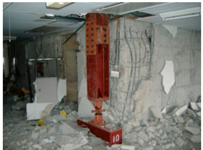
写真3.3-79 須賀川市本庁舎の2階のエレベーター周辺 2)
