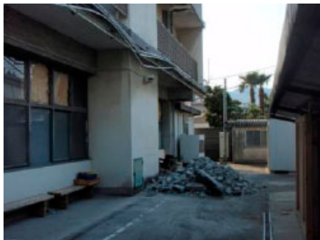
写真3.3-74 被災した亶理町役場庁舎 3)
