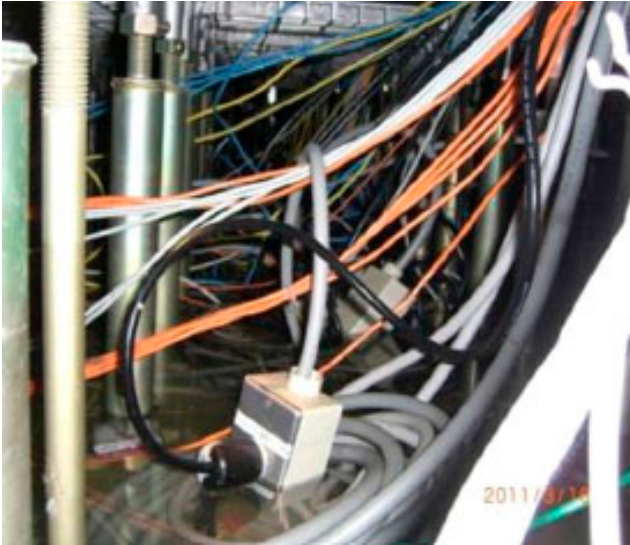
写真3.3-82 浸水したサーバールーム 1)
