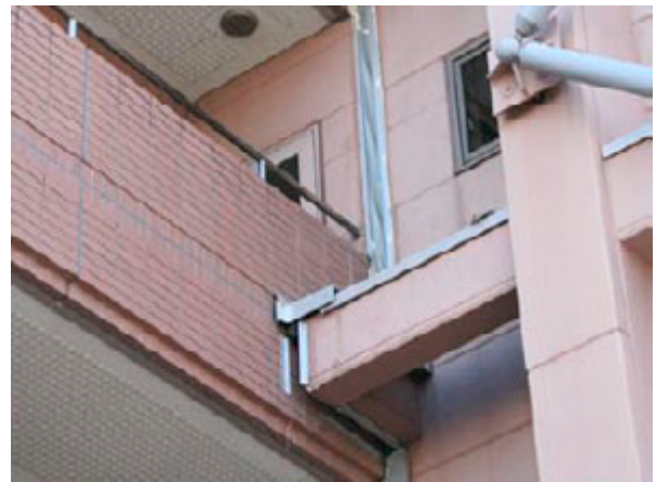
写真3.5-10 若林消防署の接続部のずれ 2)
