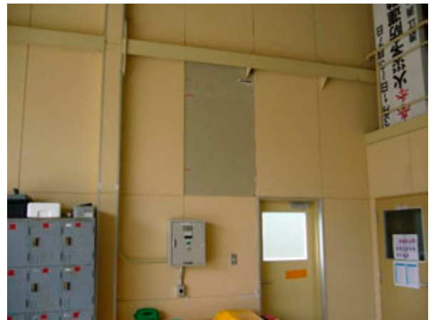
写真3.5-52 富岡消防署川内出張所の内壁の落下 1)
