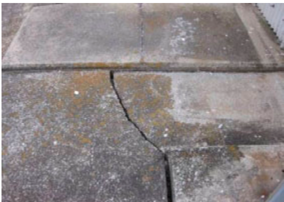
写真3.5-37 大信(たいしん)分署の大きく亀裂の入った犬走り 1)
