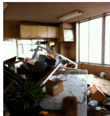
写真3.5-25 津波で浸水被害を受けた四倉分署の庁舎 2)
