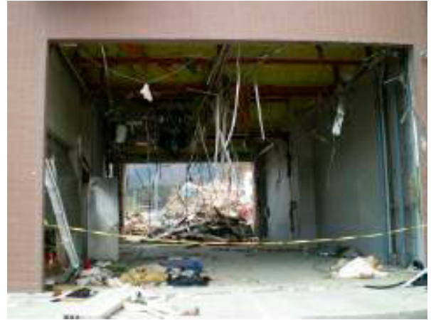
写真3.5-21 津波の襲撃を受けた女川消防署の車庫 1)
