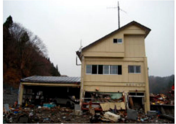
写真3.5-4 津波で使用できなくなった田老分署の庁舎 1)
