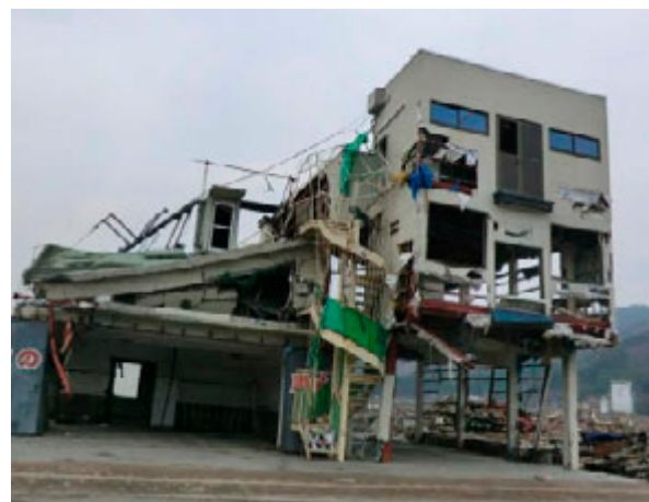
写真3.5-7 津波被害を受けた大槌消防署 2)
