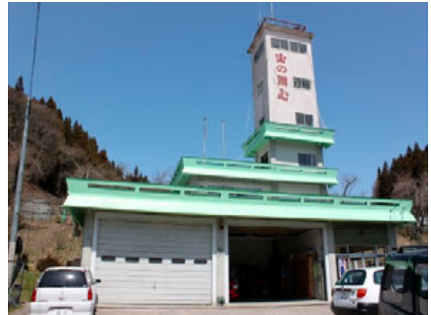
写真3.5-29 被災した鮫川分署の望楼 1)
