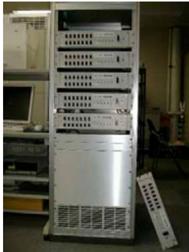
写真3.5-43 郡山地方広域組合消防本部庁舎の無線回線切替装置の破損 1)
