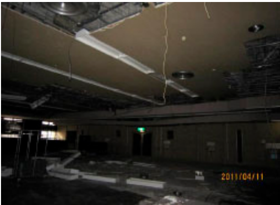
写真3.5-8 仙台市消防局庁舎の内部(天井板等が落下) 2)
