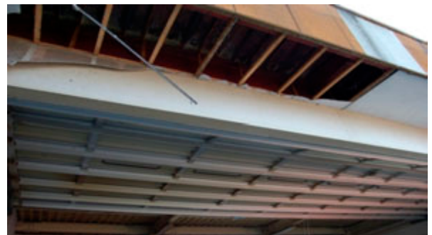
写真3.5-34 表郷(おもてごう)分署の車庫上部の被害 1)
