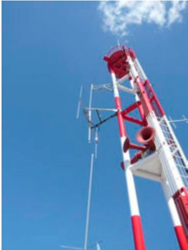
写真3.5-39 安達地方広域行政組合消防本部の救急波無線アンテナの破損 1)
