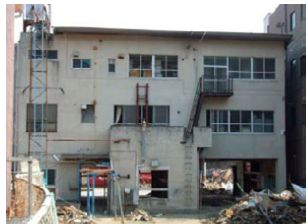
写真3.5-13 津波が通り抜け移転を強いられた南町出張所の庁舎 1)
