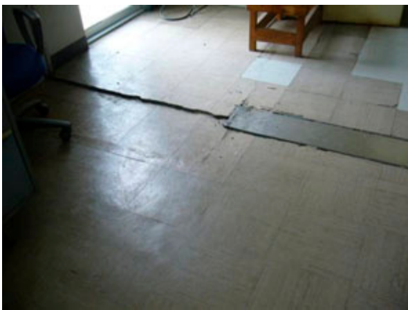
写真3.5-49 浪江消防署2階の床の亀裂 1)
