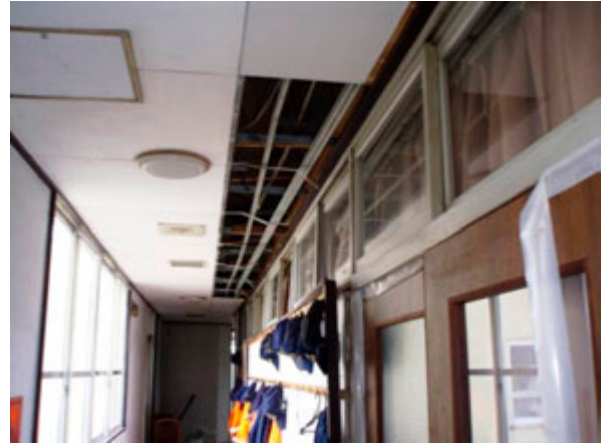
写真3.5-51 富岡消防署2階の天井の落下 1)
