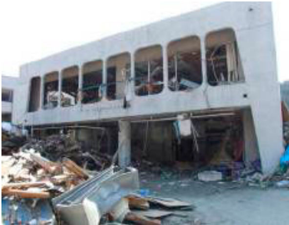
写真3.5-14 津波で2階まで被災した南三陸消防署の庁舎 1)
