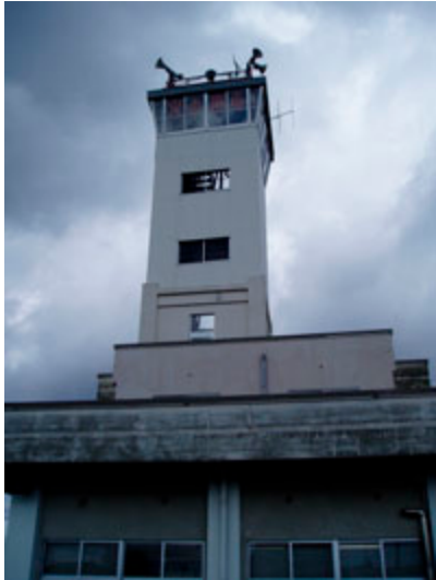
写真3.5-46 望楼が破損した石川消防署浅川分署 1)
