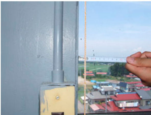
写真3.5-47 浅川分署の望楼の鉄骨が傾斜している状況 1)
