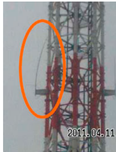
写真3.5-42 郡山地方広域組合消防本部庁舎の屋上アンテナの破損 1)
