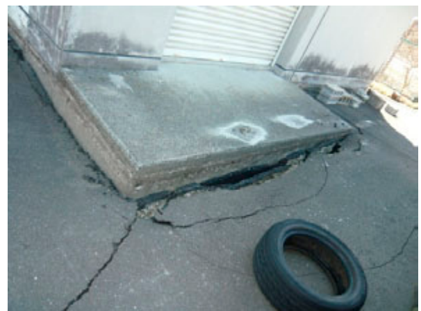
写真3.5-38 安達地方広域行政組合消防本部周辺の地盤陥没 1)
