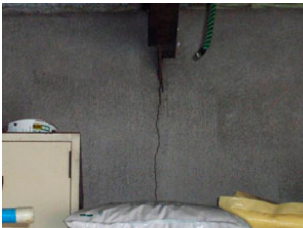
写真3.5-50 葛尾出張所の内壁の亀裂 1)
