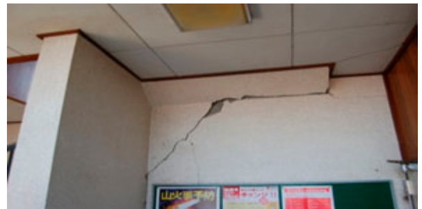
写真3.5-33 被災した表郷(おもてごう)分署の建物内部の壁体 1)
