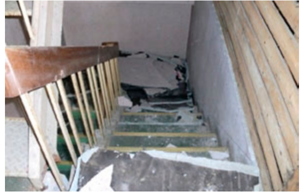
写真3.5-32 被災した西郷分署望樓の階段室 1)
