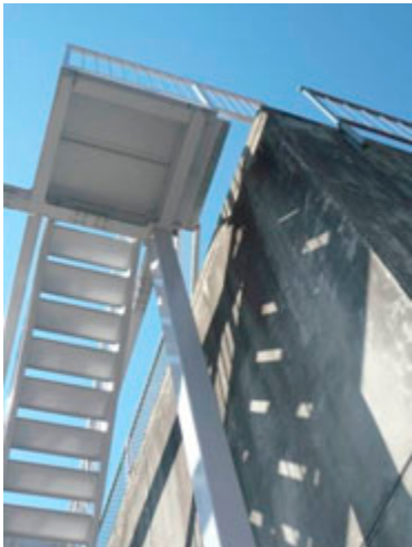
写真3.5-40 安達地方広域行政組合消防本部の屋外階段の傾斜 1)
