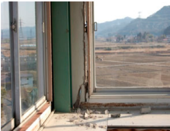
写真3.5-31 被災した塙分署の望樓内部 1)
