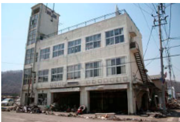
写真3.5-6 1階部分が津波で水没した釜石消防署 1)
