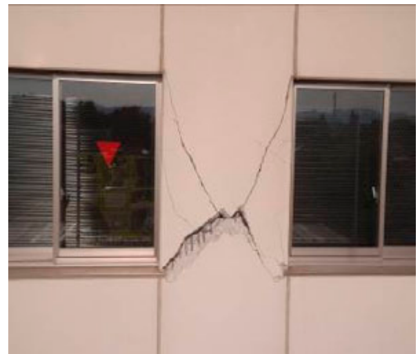
写真3.5-41 郡山地方広域消防組合消防本部庁舎の外壁の破損 1)
