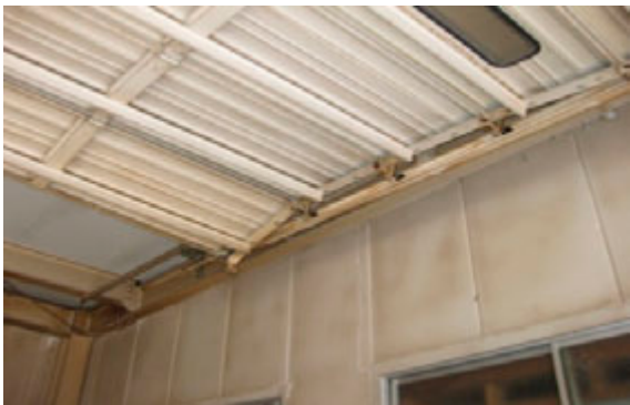
写真3.5-36 大信(たいしん)分署の大きく変形したシャッター 1)
