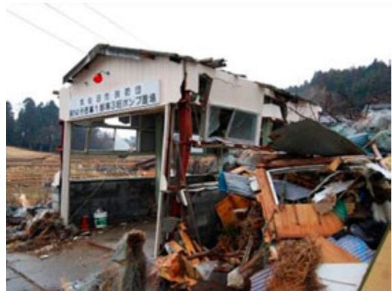
本吉町大沢漁港の被害状況
