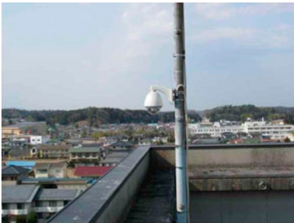
写真4.8-18 火災監視カメラ (双葉地方広域市町村圏組合消防本部提供) 2)
