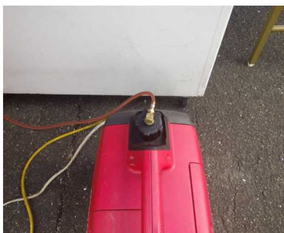
写真3 発電機とビニール製の配管の接続状況
