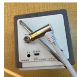
テレビ用コンセントへの接続状況
