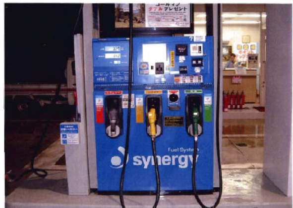
図 4-11 固定給油設備
