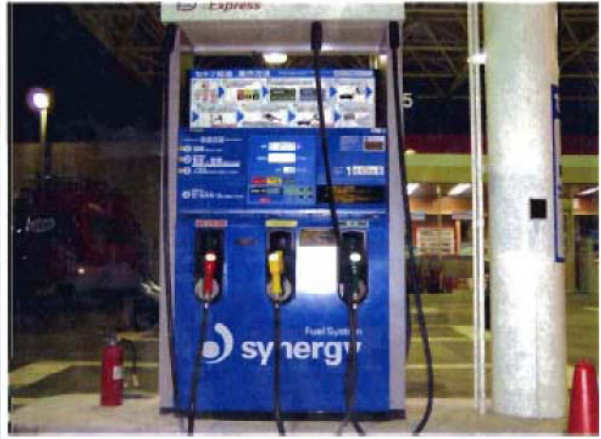
図 4-9 固定給油設備
