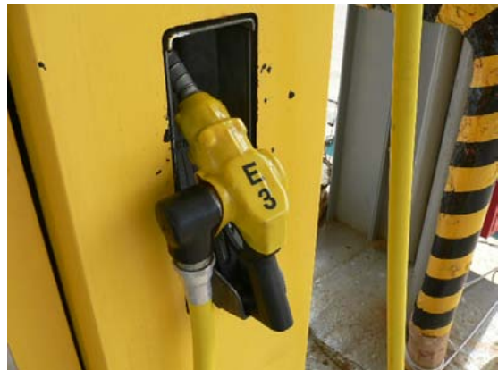
写真 4-1-18 ノズルとホース（交換済み）
