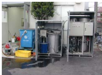
No. 8 バイオマス燃料(ETBE)及びE3の 油分離槽の排水に関する検証試験 試験装置概要 ■浄化装置内部 ※左側の分離槽から中央の曝気槽を経て右側の活性炭槽に排水を送り処理します。
