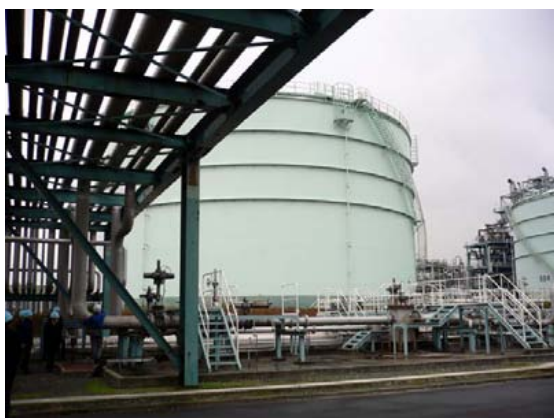
写真 3-1-1 ETBE 貯蔵タンク
