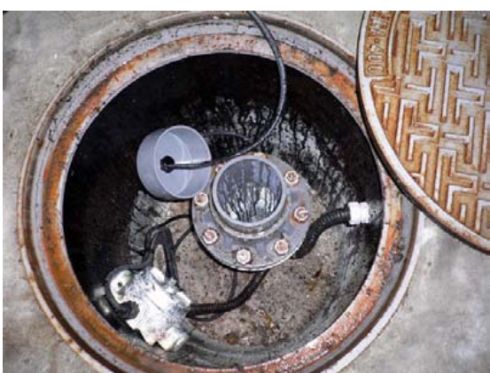
写真 3-1-15 土中センサー挿入部
