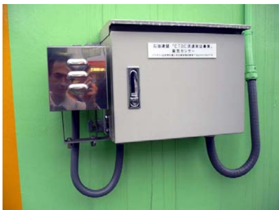
写真 3-1-9 臭気センサーと記録装置
