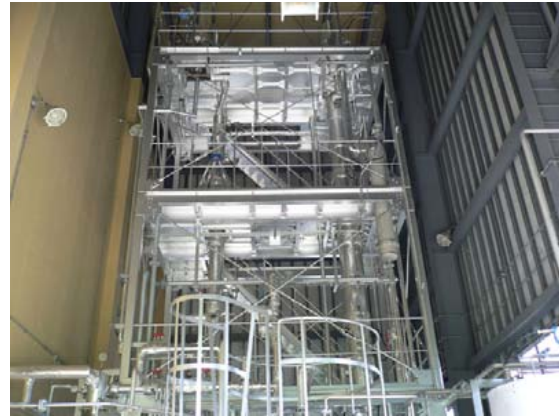
写真 4-1-4 もろみ塔・濃縮塔
