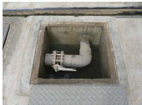
写真 4-1-20 設置された緊急遮断弁
