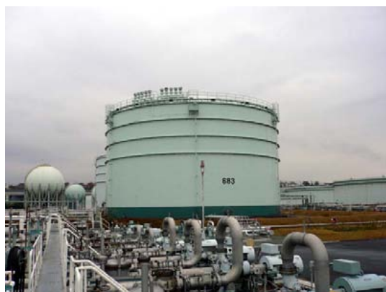
写真 3-1-2 ETBE 混合ガソリン貯蔵タンク
