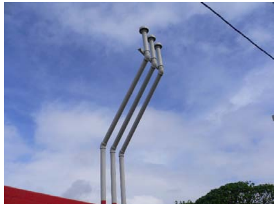
写真 4-1-16 通気管（大気弁無し）
