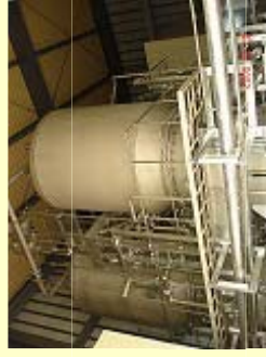
培養・蒸留設備
