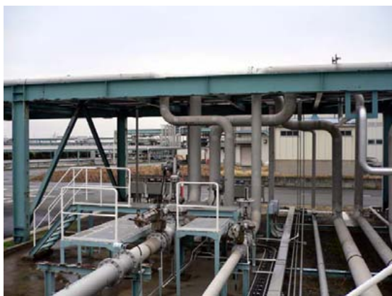
写真 3-1-3 ガソリンラインと ETBE ライン
