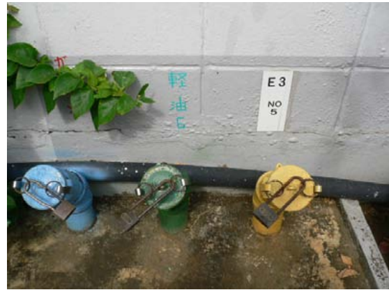
写真 4-1-22 地下タンクの E3 表示
