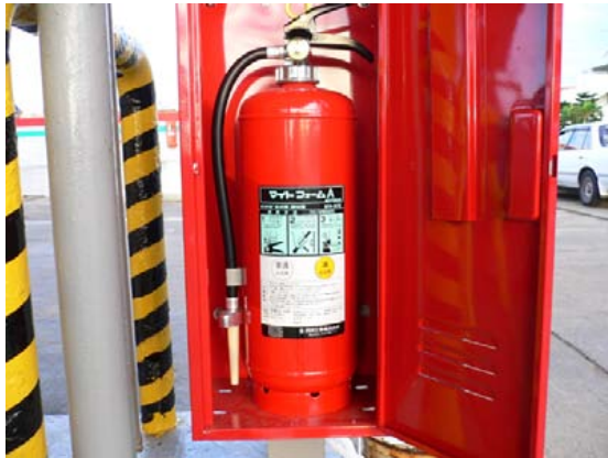
写真 4-1-21 泡消火器(耐アルコール泡)
