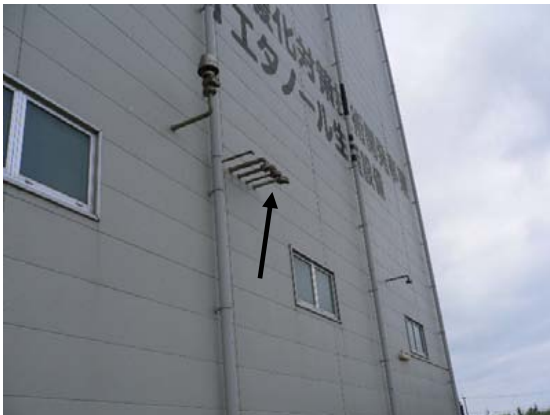
写真 4-1-7 安全弁吹き出し口
