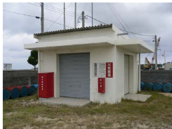
写真 4-1-13 E3 燃料屋内貯蔵設備
