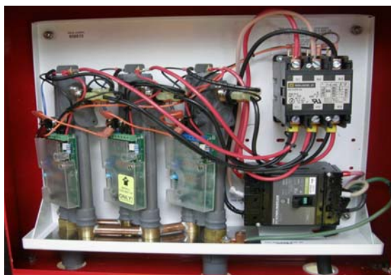
写真2 温水装置内部
