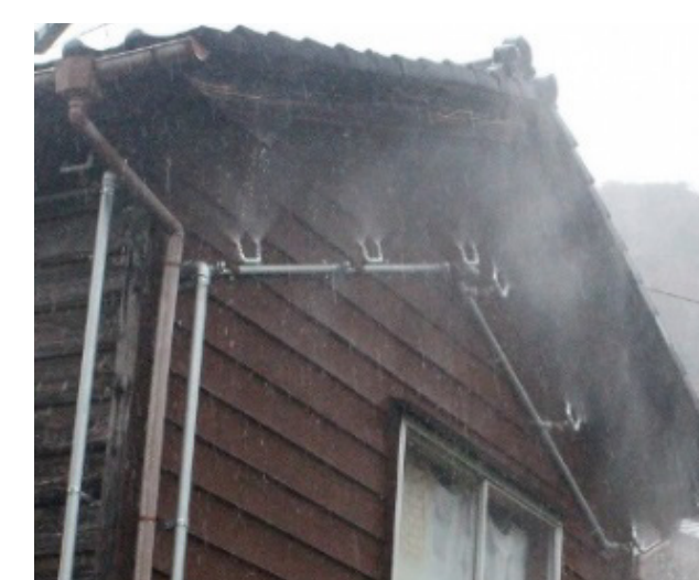
固定型ドレンチャー式
