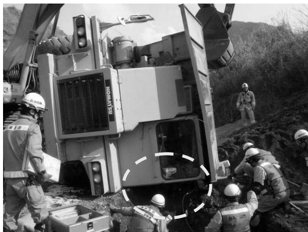
オフロードダンプカーの横転事故、点線部分に要救助者が挟まれている
