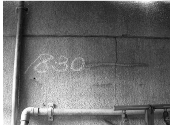
亀裂に対し垂直にマーキングし時刻を記入
