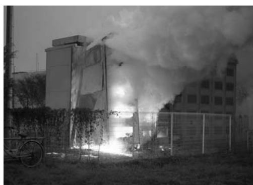
延焼中のN A S 電池システム
