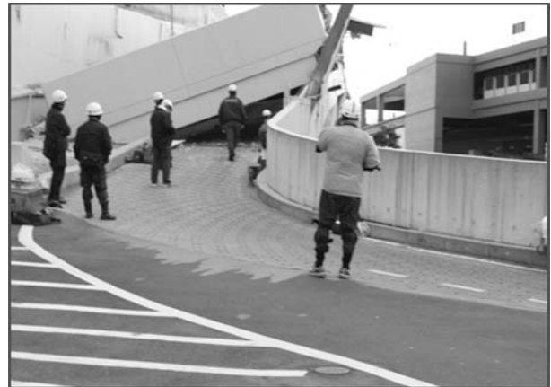
駐車場入口スロープの状況（崩落後）
