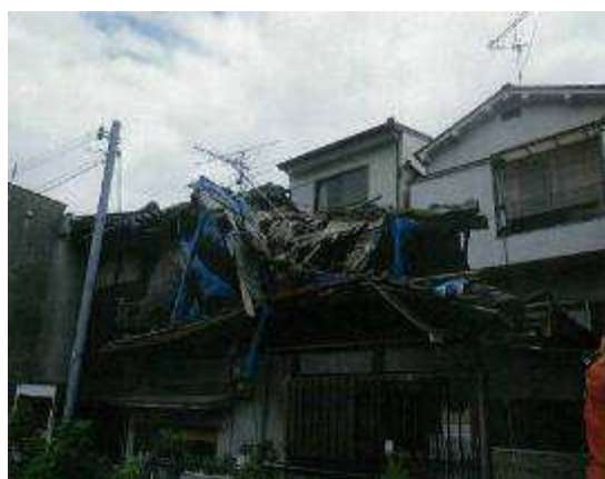
崩落住宅の状況〈図－1〉
