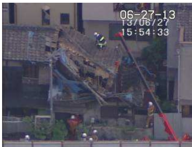
崩落住宅の俯瞰〈図－４〉
