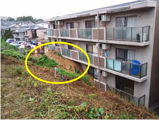
土砂流入状況（屋外から）
