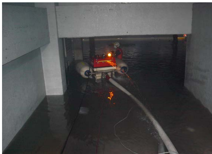
フロートジェットポンプより延長された 100mm ホース
