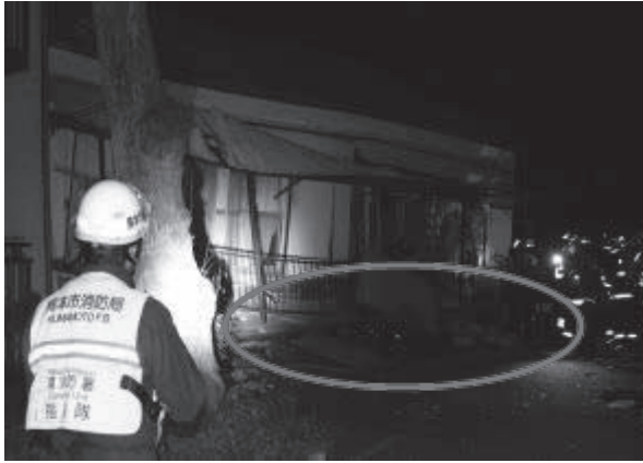
発災後南側1階が完全倒壊
