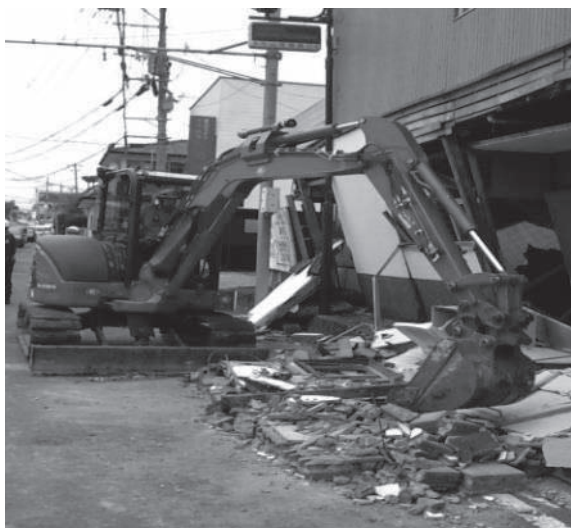
倒壊建物の危険排除活動状況
