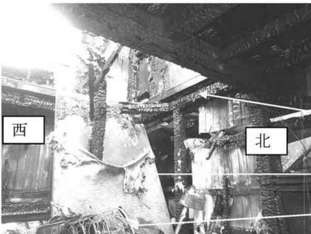
玄関上部崩落の状況 (内部から撮影)
