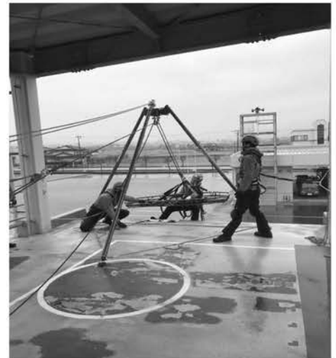
【テラダプター使用について検証が必要】
