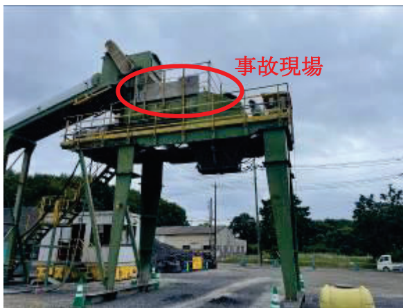
道路補修材製造プラント（高さ約7m）
