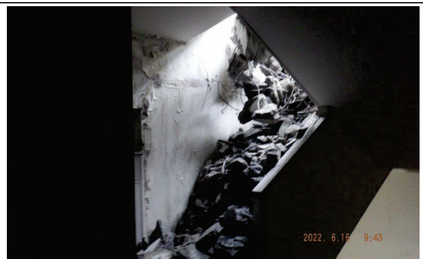
④ 瓦礫が堆積した8階から9階への階段
