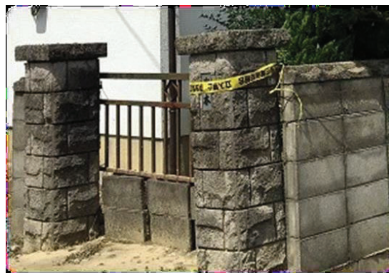
立入禁止テープによる表示
