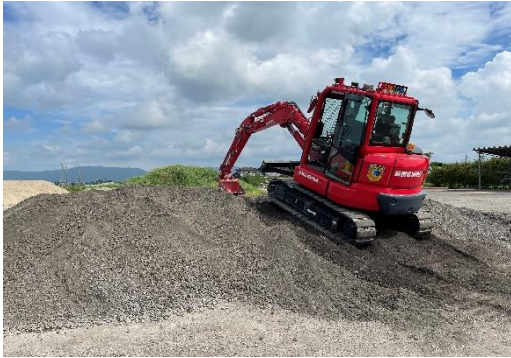
道路啓開（登り）
