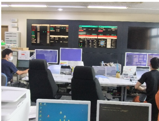
写真 1 南国市消防本部通信指令室
