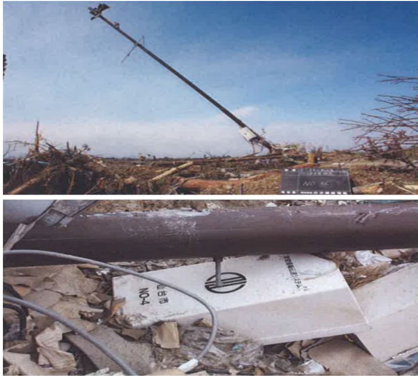
図1 津波により被災した屋外拡声装置
