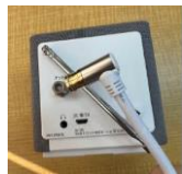
テレビ用コンセント への接続状況
