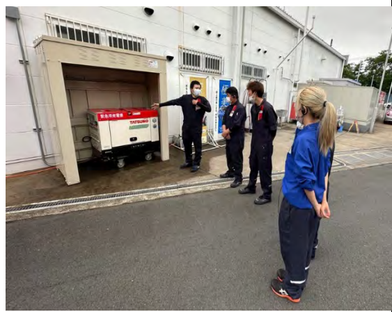
非常用発電機取扱訓練
