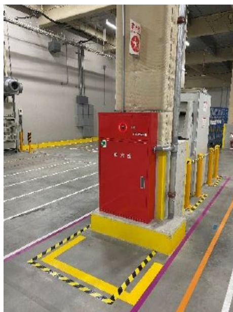
実例(4)イ：屋内消火栓設備の周囲に物品を置いてはいけないことをテープにより明示するとともに、屋内消火栓設備の位置を明示する標識を設置
