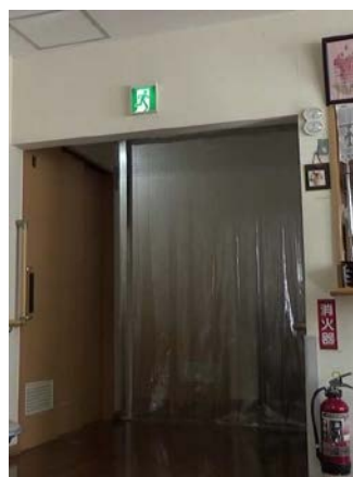
【図 3－3 8】遮煙カーテン （施設への設置例）
