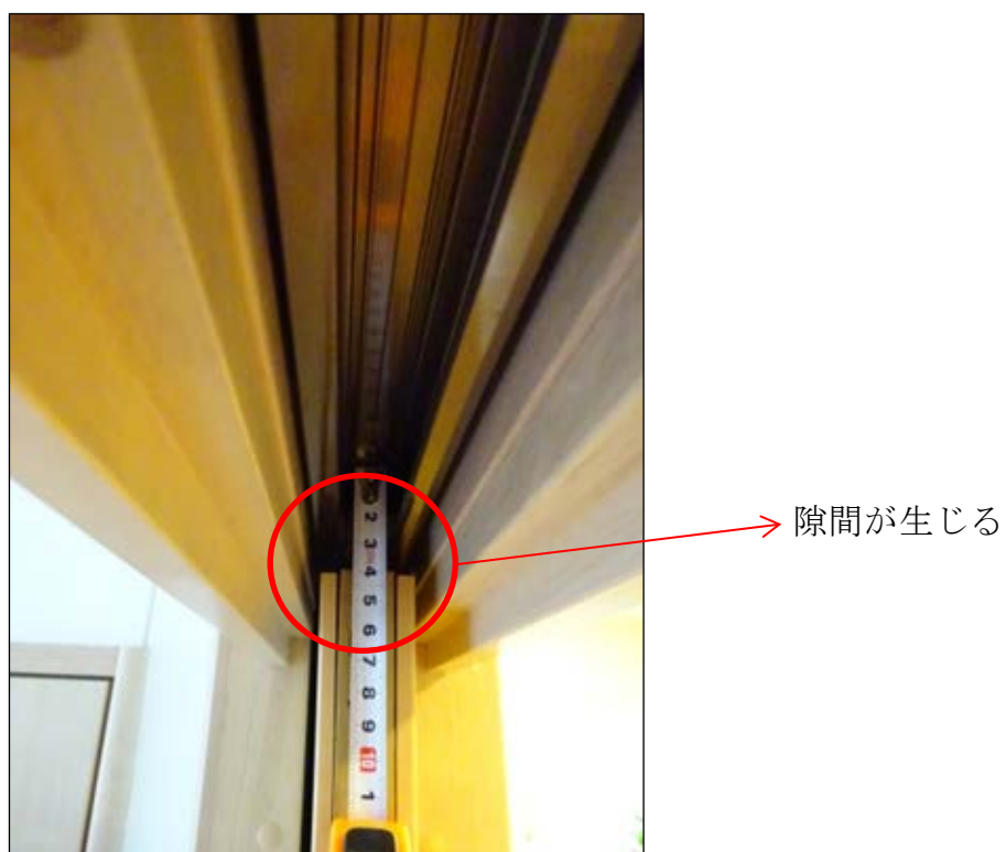
【図 3－30】吊り引き戸の隙間
