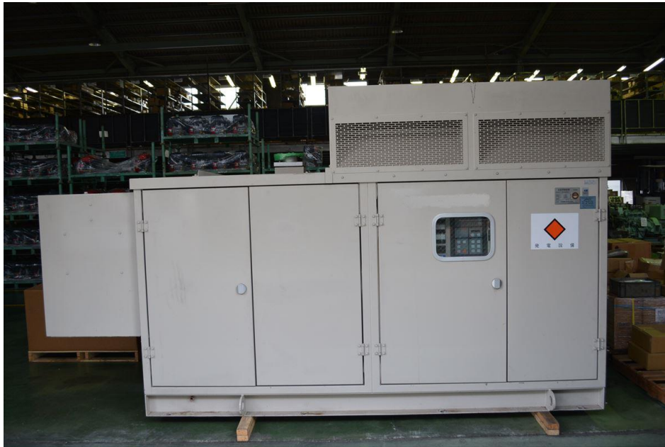
キュービクル式自家発電設備の例
