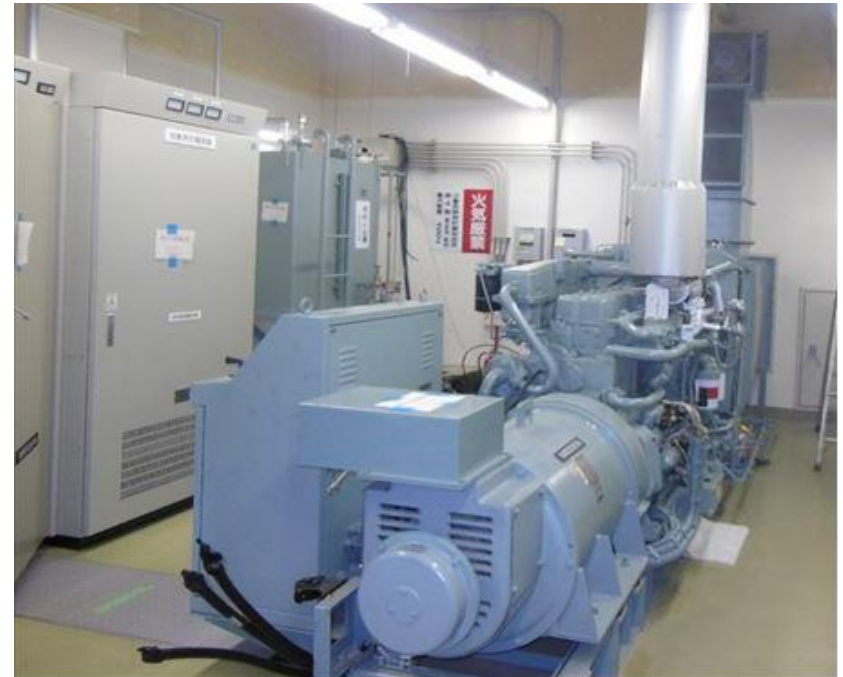
キュービクル式以外の自家発電設備の例
