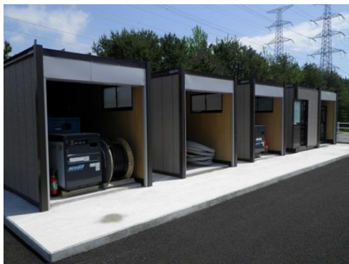
写真 2-5 高台に設けた非常用資材庫
