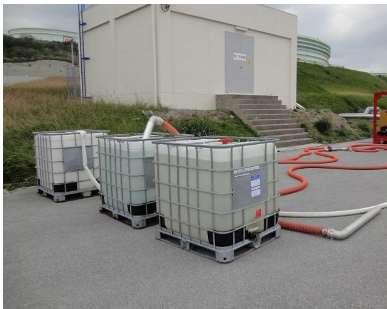
写真 1-3 大容量泡放水砲用泡消火薬剤
