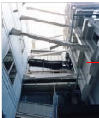
連結制震部材(アンボンドブレース)
