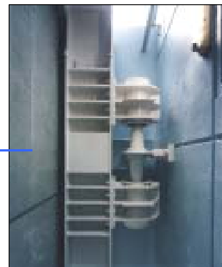
連結制震部材(ジョイントダンパ)
