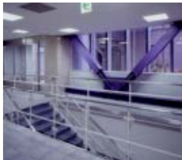
別館棟 補強後の内観 (座屈拘束ブレース)
