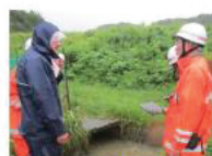
(ため池堤体からの漏水現場にタブレットを持参)
