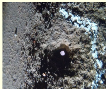
(1-1)内面腐食穿孔
