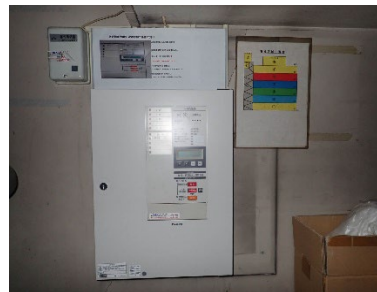
図 23 受信機設置状況
