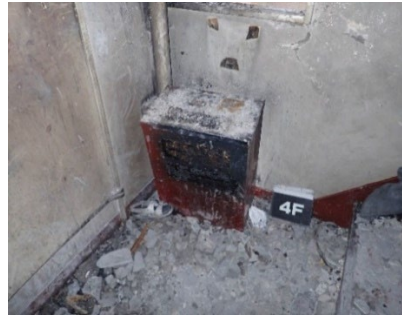
図 22 避難はしご収納箱設置状況
