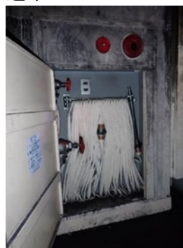
図 13 屋内消火栓内部
