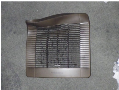
図 37 変形した換気口
