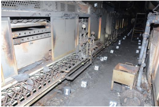
図 5：出火場所付近のガス配管見分状況
