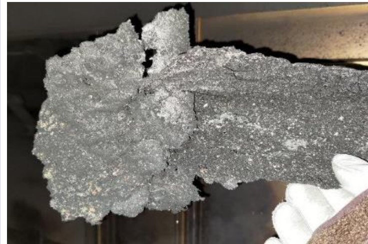
図11：天井から落下した残渣物
