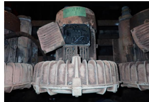
図 6：出火場所付近の電気設備見分状況
