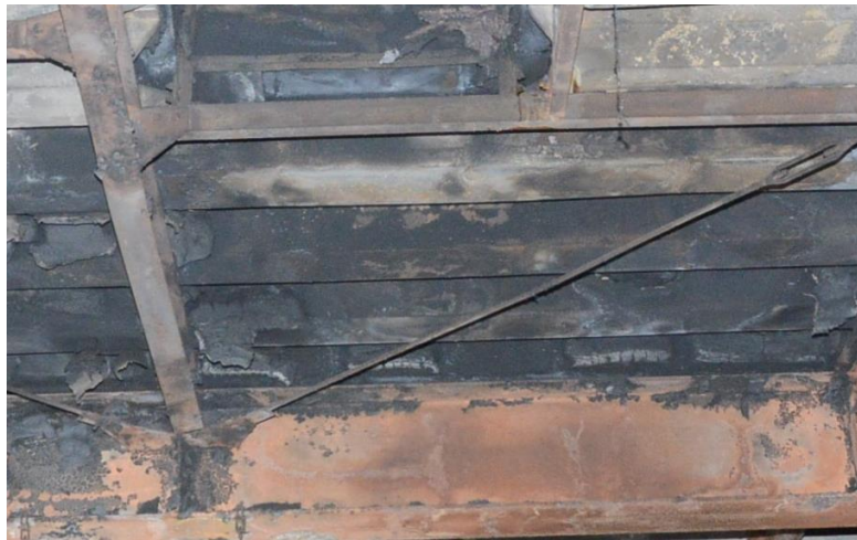
図10：出火箇所付近の天井の様子
