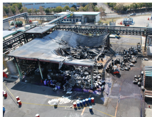
廃油再生燃料の製造所で発生した火災事例
